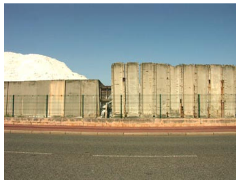
Contre-exemple : des casiers béton en mauvais état le long de la limite.
